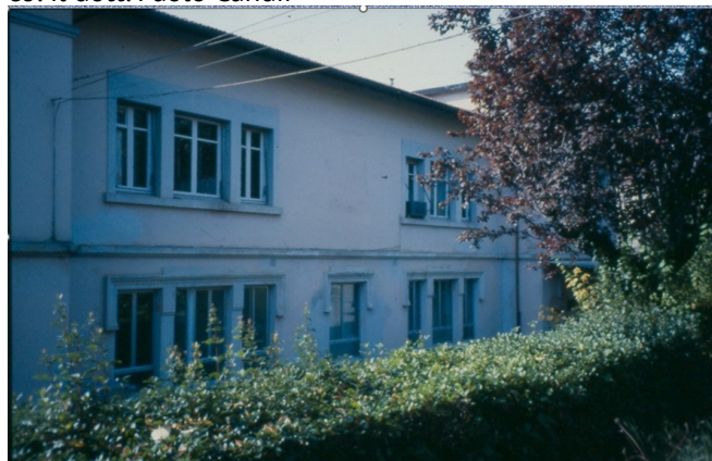
Figura 4: La palazzina con la lavanderia al piano terra e la Nefrologia e Dialisi al primo piano
